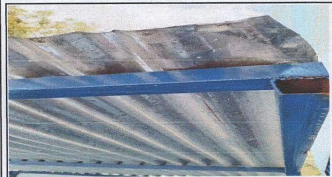
Foto 3: TECHO EN PATIO
