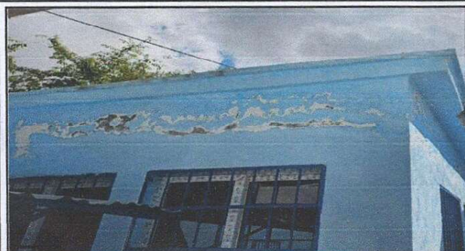
Foto 1: TERRAZA EN MAL ESTADO DE LA BODEGA
