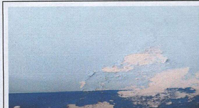
Foto 4: REPELLO DE COCINA EN MAL ESTADO
