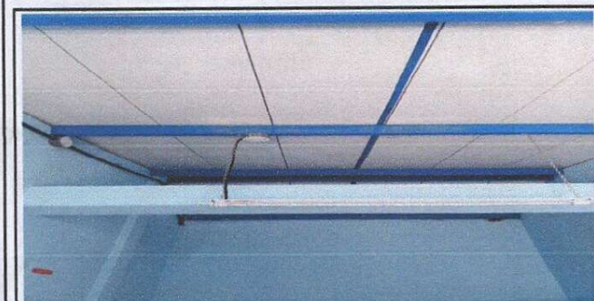
Foto 5: SISTEMA ELECTRICO DAÑADO EN COCINA
